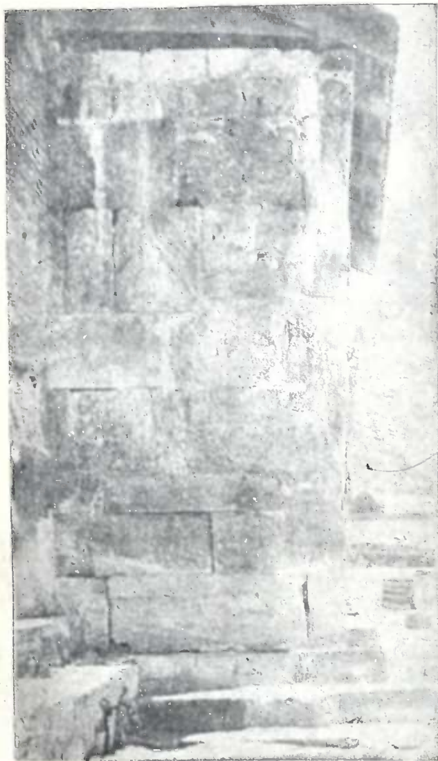
Рис. 26. Вид с востока на угол северной галлерей с показом отклонения северной стены.
