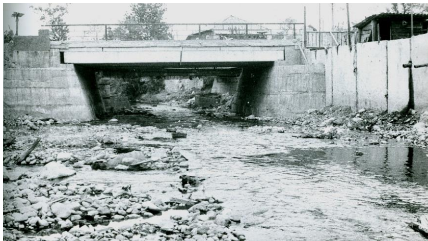
ნახ.4. ა. მდ.ყოროლისწყლის ჩახერგილი უბანი (მარჯვენა ნაპირზე დანგრეულია ნაპირსამაგრი რკინა-ბეტონის კონსტრუქციის კედელი წყალმოვარდნის შედეგად 1979 წ. 31.08-01.09), ბ. მდ. ბარცხანაზე ძველი ხიდის ადგილას M აშენებულ იქნა ახალი (1979წ.), რომელიც დაიტბორა წყალმოვარდნის წყალგაუმტარობის გამო ცხრილი 1. გამოთვლების შემოწმების შედეგები
